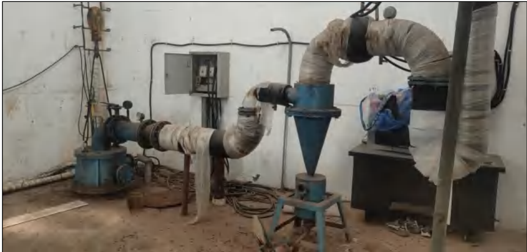
照片1.3-3 R5井室内开采管道及监测设备
