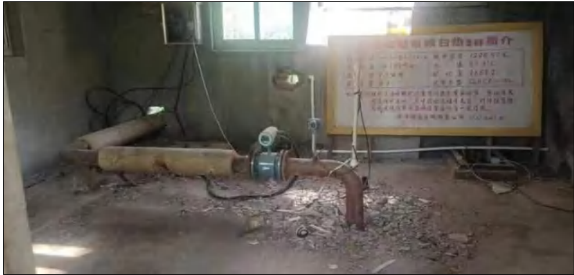
照片3.3-5 R3井室内井口及监测设备
