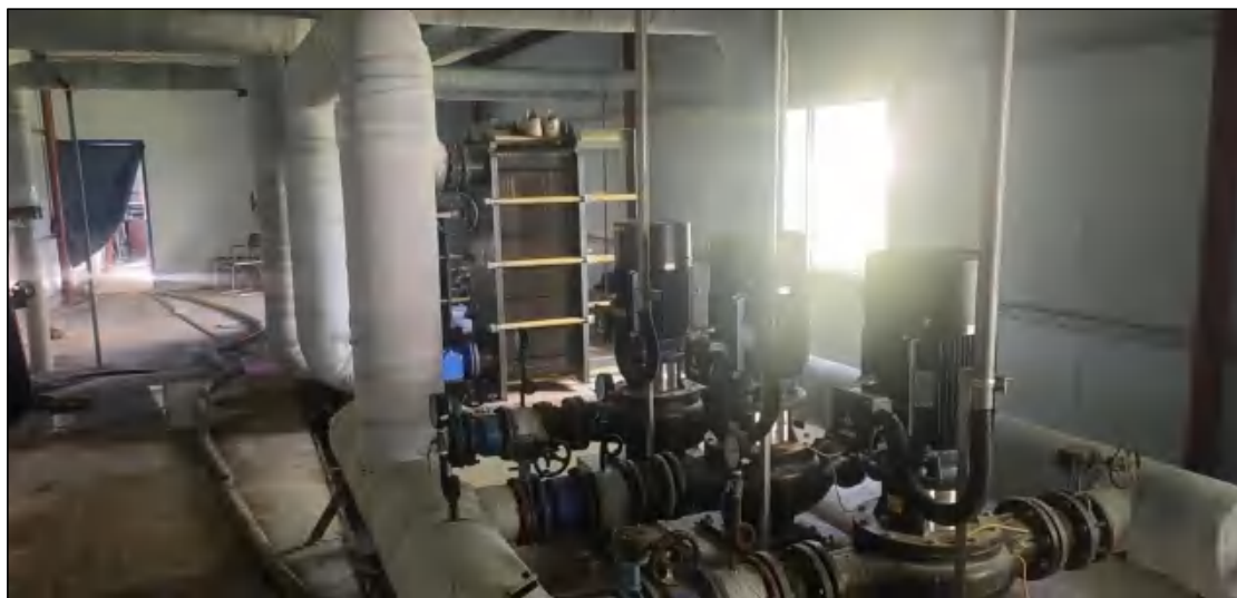
照片3.3-7 温泉花园换热站内部设备
