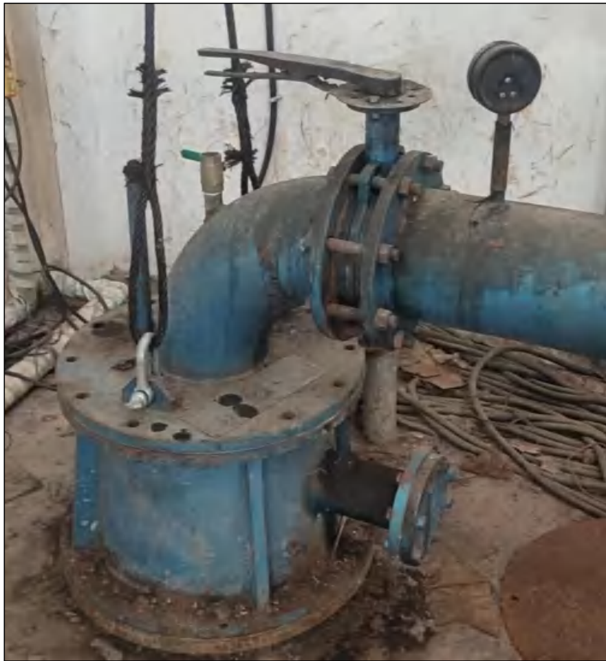
照片3.3-2 R5井室内井口
