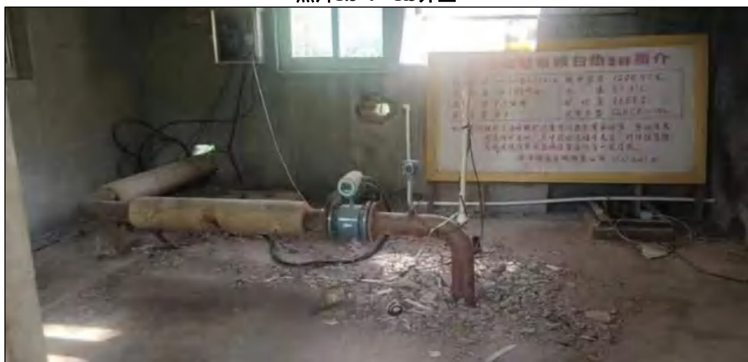
照片1.3-5 R3井室内井口及监测设备
