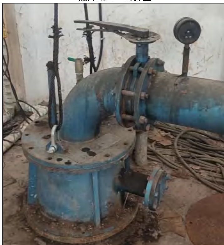
照片1.3-2 R5井室内井口
