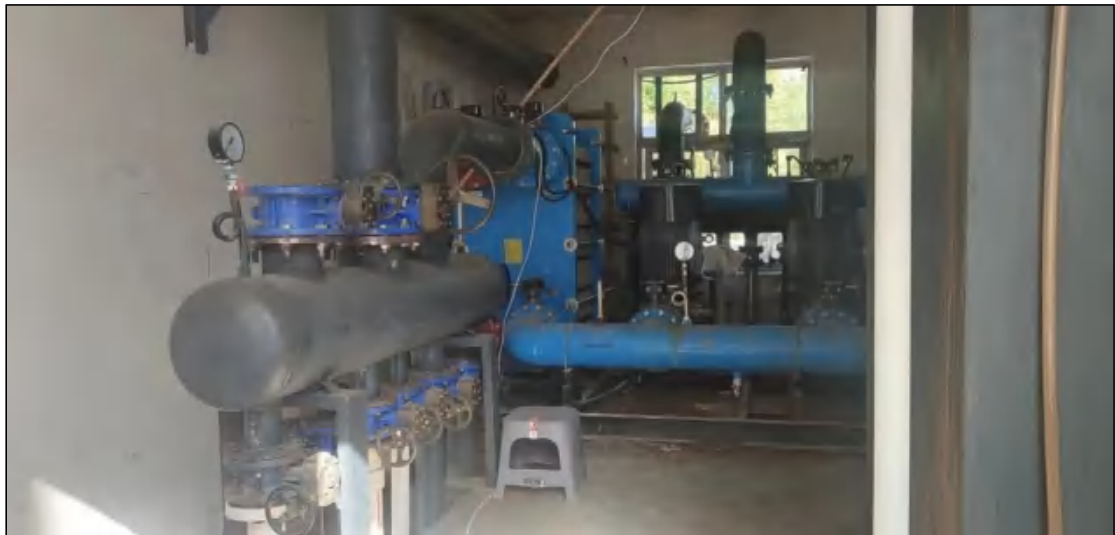
照片1.3-9 商业街换热站内部设备
