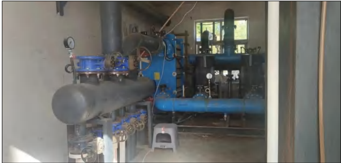
照片3.3-9 商业街换热站内部设备
