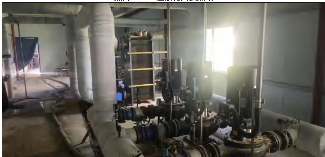
照片1.3-7 温泉花园换热站内部设备
