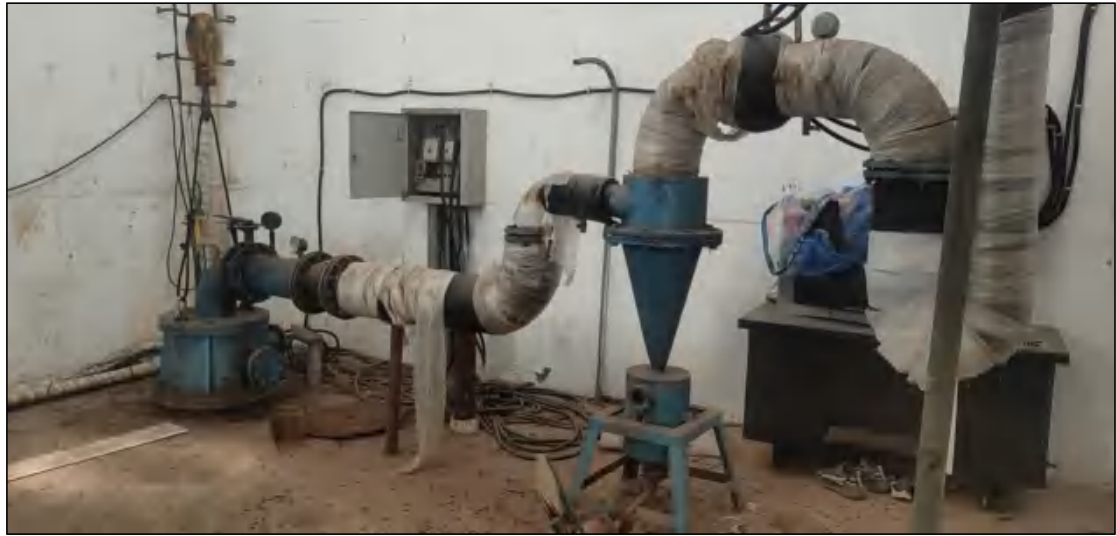
照片3.3-3 R5井室内开采管道及监测设备
